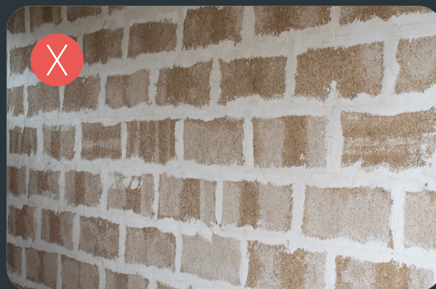
Foute uitvoering van de voegen
